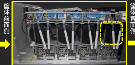
右側面から見た電源部
